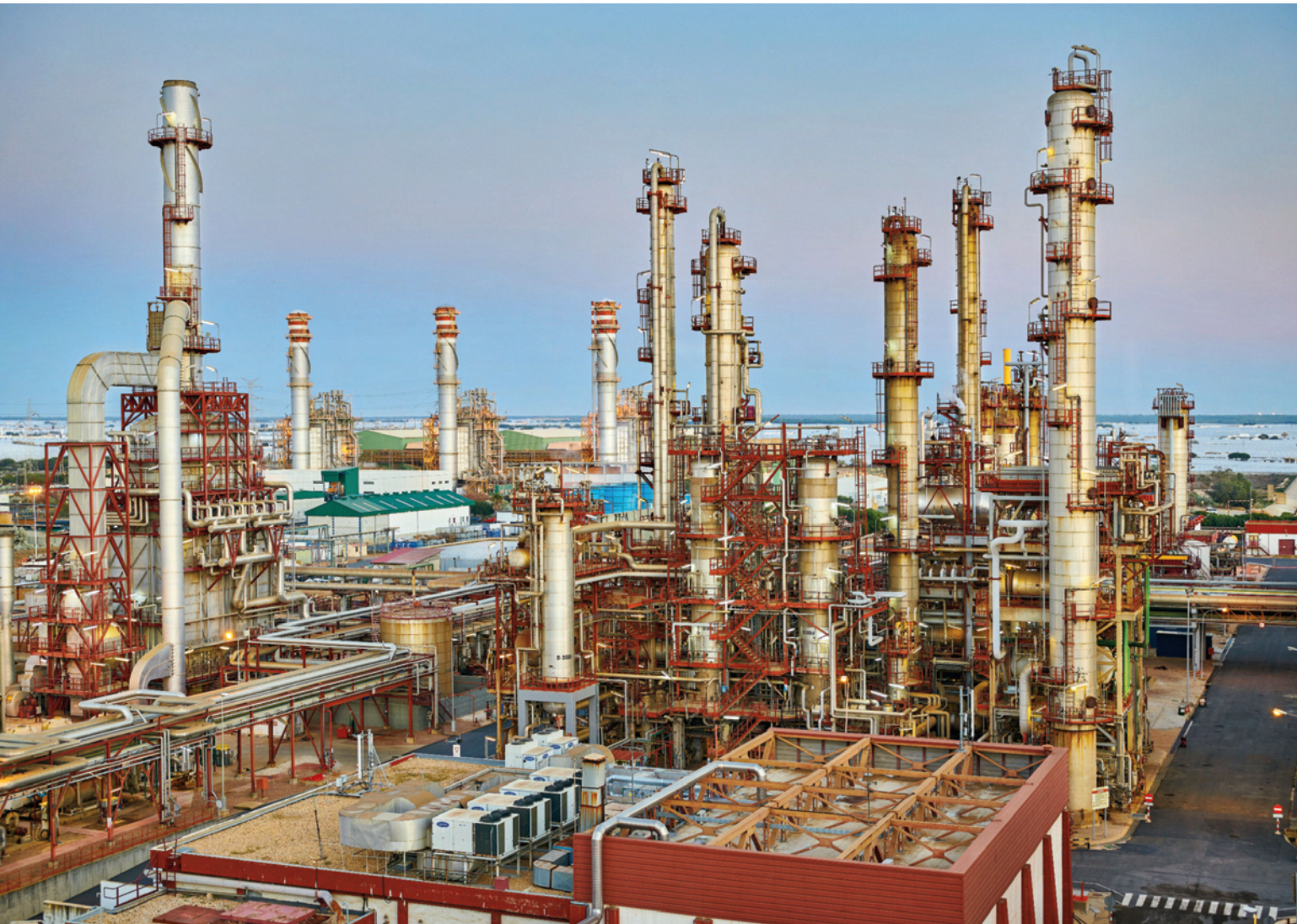
Instalaciones industriales de Cepsa en Andalucía
