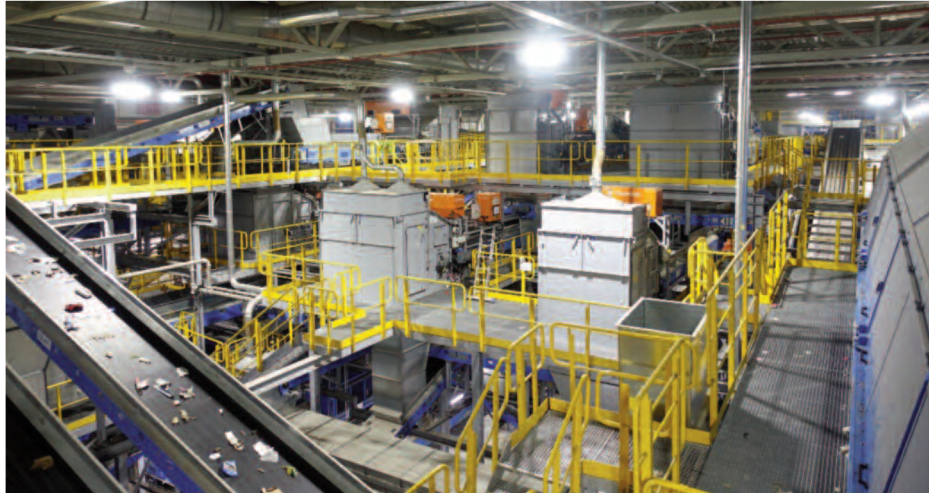
Planta de tratamiento equipada por Tomra
