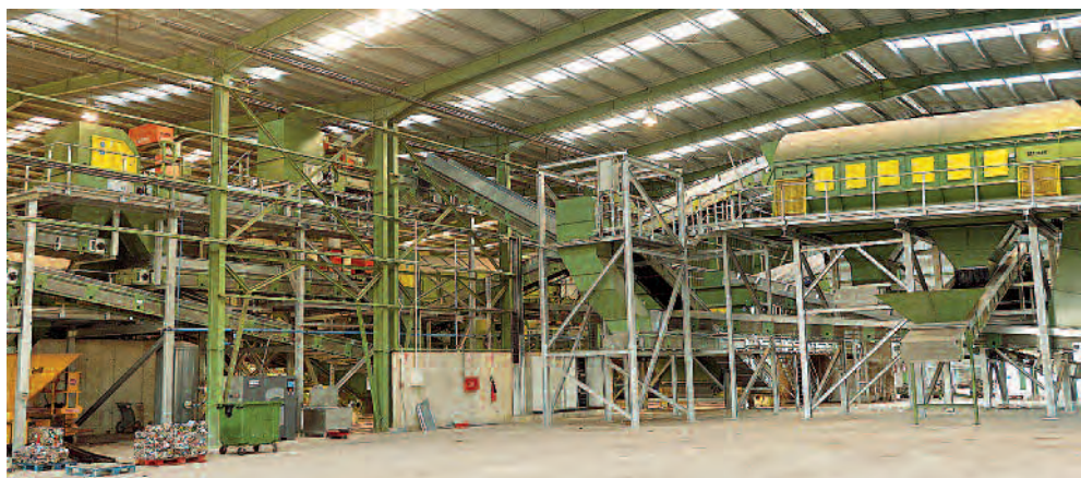
Planta de tratamiento de Limusa
