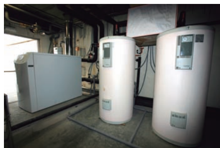
Sala de calderas en lo alto del edificio
