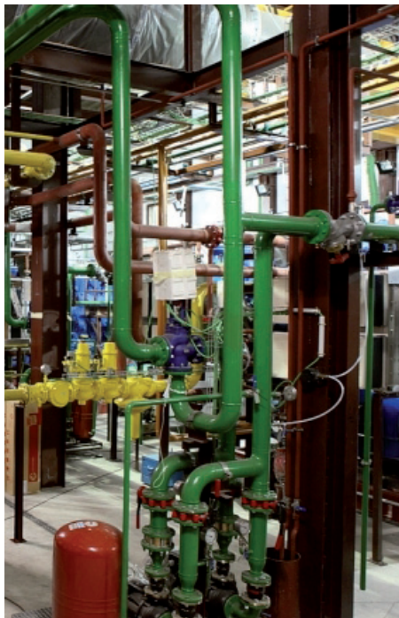
Instalación de cogeneración El Pozo
