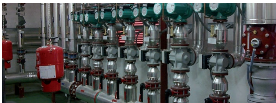
Instalación de Seproi Ingeniería de Instalaciones
